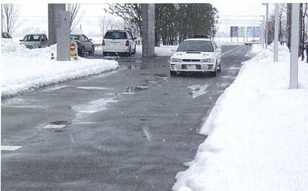
福井市「福井県立図書館 構内道路融雪」 融雪面積：1000㎡ 杭：PHC打撃工法166本φ600～450杭兼用 施工：'00～'02年
