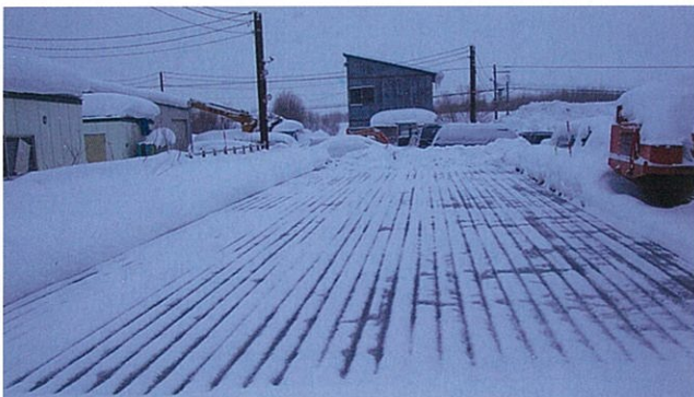
北海道札幌市「榎日伸テクノ 駐車場融雪」融雪面積：147㎡ 杭：鋼管ねじ込み36本φ139.8専用杭 施工：'05年
